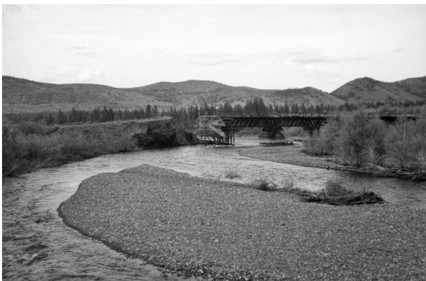
Рис. 9. Разрушенный наводнением мост. Оймяконский улус. 2004 г. Фото автора
